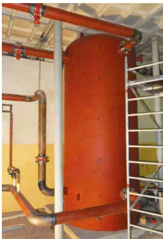
Akumulační nádrž, kotelna Třešť
