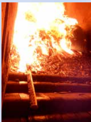
Provoz na kotelně U Hřbitova 21 v Jihlavě zahájen
